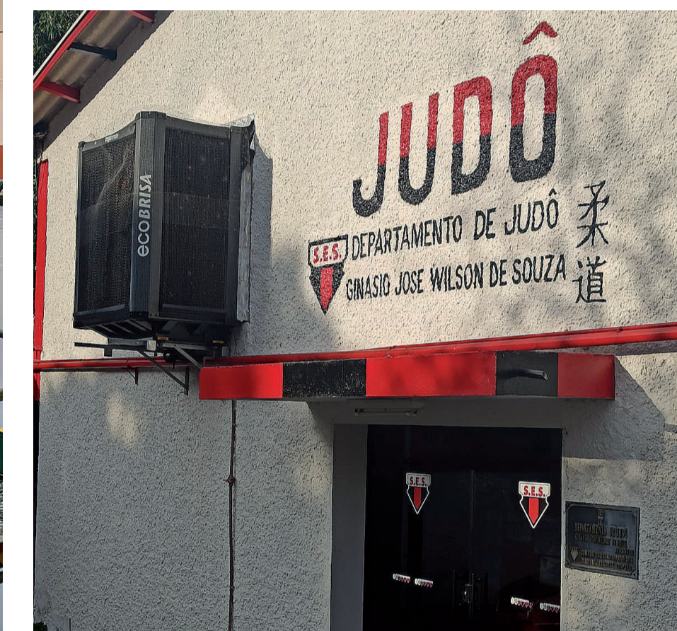
Dojô foi um dos setores contemplados com climatizadores
